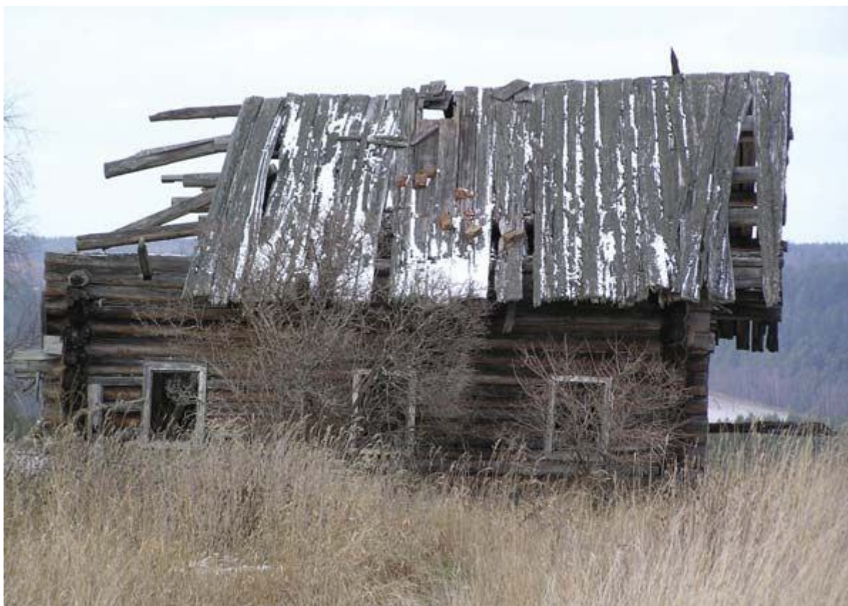
Рис. 2. Разрушенная баня и хозяйстройки
