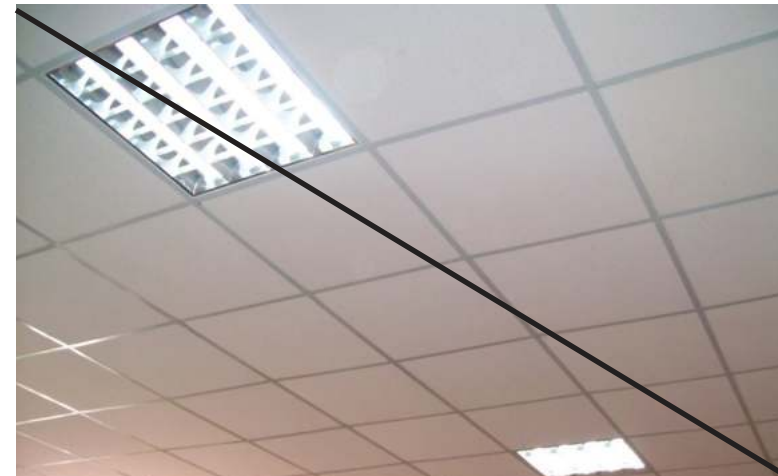
Плохо Открытые направляющие
