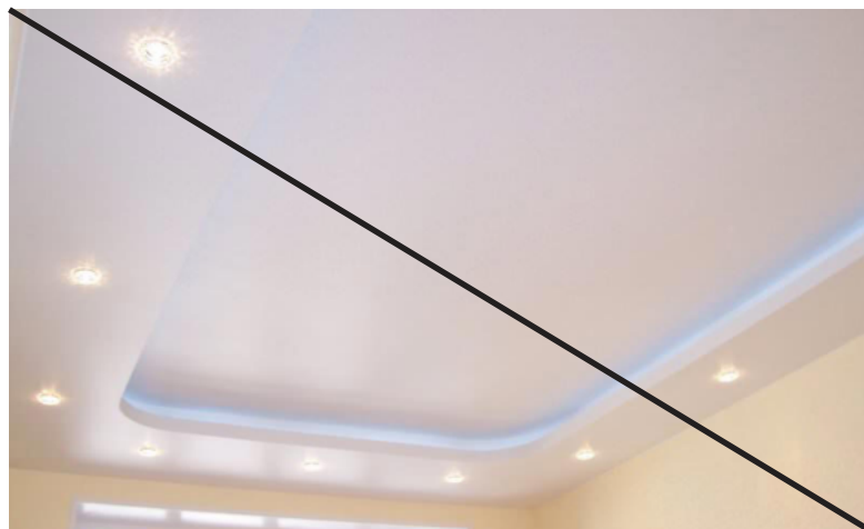
Плохо Многоуровневые гипсокартонные конструкции
